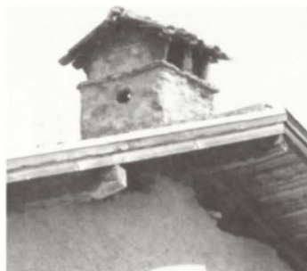
Fig. 13 fumaiole con copertura a doppio spiovente
